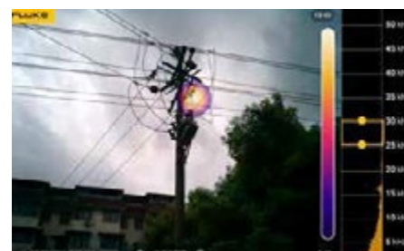
10kv 线路杆塔绝缘子放电
