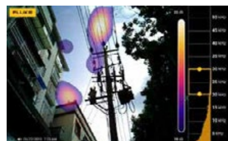
10kv 线路杆塔线夹和绝缘子放电
