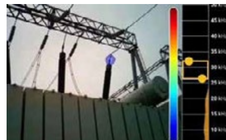
变压器出现接头放电
